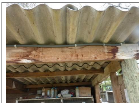
Photo n° 867A1 Localisation : Abris foin Ouvrage : couverture onde fibrocimet amiante M001
