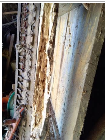
Photo n° PhTer001 Localisation : grange partie ouest Ouvrage : Palette, Poutres (Bois) - Charpente Description : PhTer001 Localisation sur croquis : PhTer001
