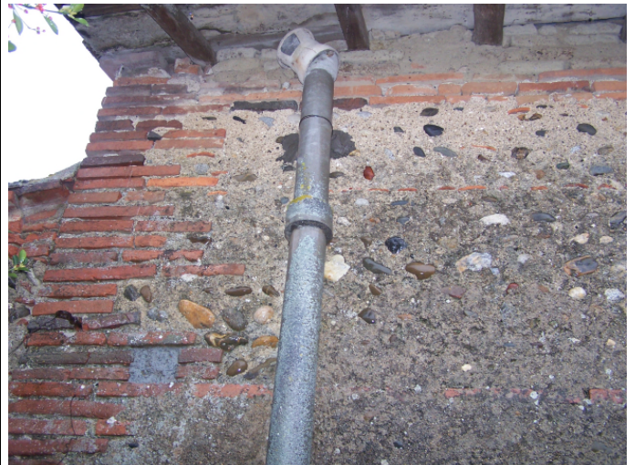
Conduit évent fosse septique WC amiante ciment mur extérieur maison
