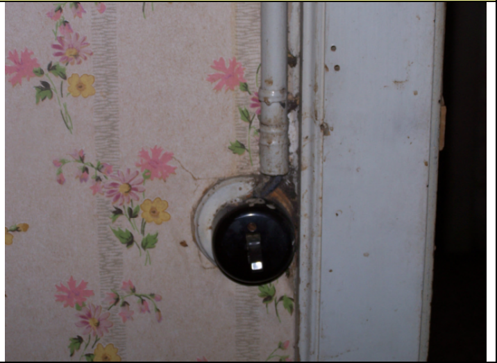
Matériel vétuste : conduit fro
