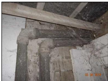
Cave à Vins: Conduits (F-C)
