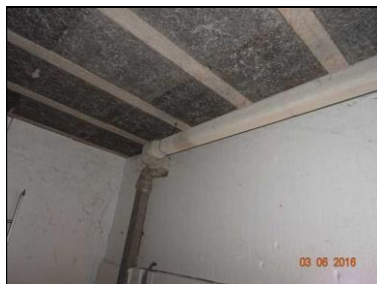
Cave à Vins: Conduits (F-C)
