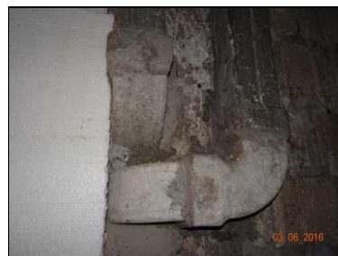
Cave à Vins: Conduits (F-C)
