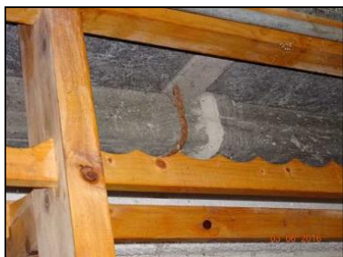
Cave à Vins: Conduits (F-C)
