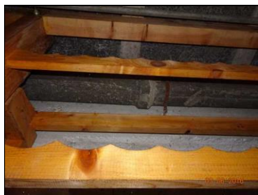
Cave à Vins: Conduits (F-C)
