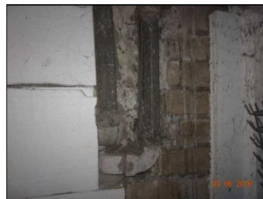
Cave à Vins: Conduits (F-C)
