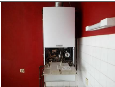
Photo n° Gaz001 Localisation : 2ème étage - Cuisine / Séjour Chaudière Vaillant (Type : Raccordé)
