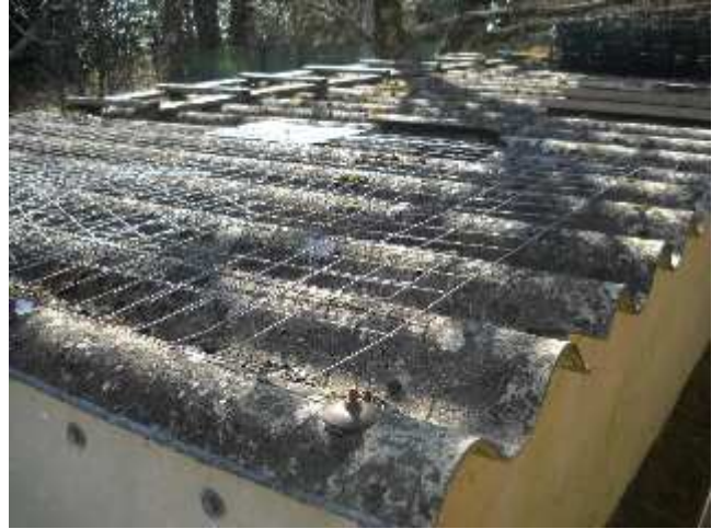
027 - Maison - Bucher PH2 : amiante ciment
