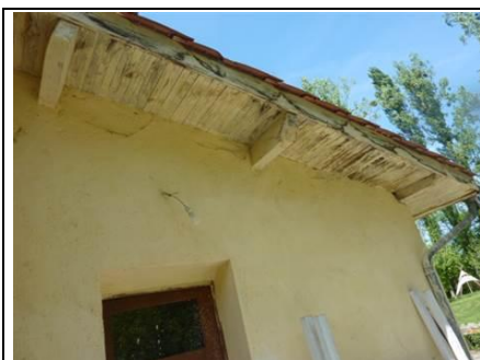
Photo n° 883T1 Localisation : Chaufferie : extérieur Ouvrage : avant toit et planche de rive (problème d'humidité) entretien à revoir
