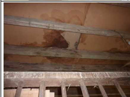
Photo n° 883T2 Localisation : Grenier 2 Ouvrage : panneau bois plancher trace d'humidité
