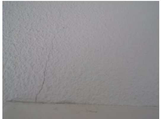
Séjour : Mur droite Gouttelette
