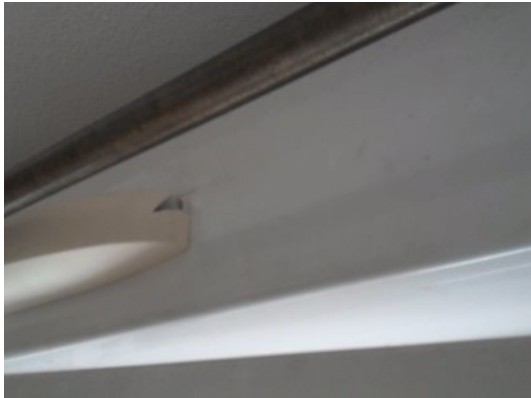
Séjour : Ventilation Grille d'aération
