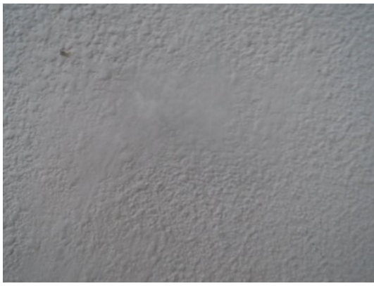
Hall d'entrée : Mur droite Gouttelette
