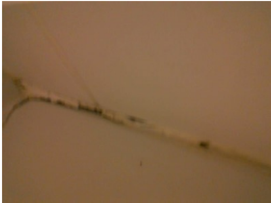
Salle de Bains /WC : Baignoire : Joint Silicone
