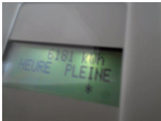
Compteur Électricité : Heures pleines
