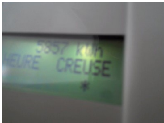
Compteur Électricité : Heures creuses
