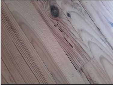
Altérations dans plancher de la chambre 1 sans présence d'individus le jour de la visite
