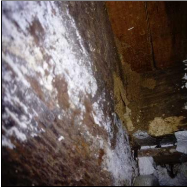
traces de termites sans présence d'individus le jour de la visite sur une poutre de l'escalier
