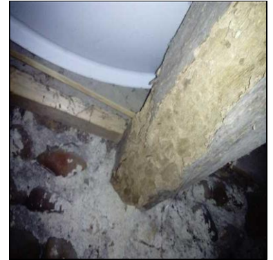
traces de termites sans présence d'individus le jour de la visite sur une poutre de l'atelier
