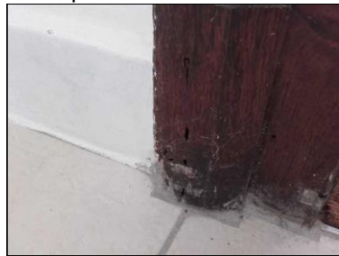
Altérations dans le bois sur montant de porte cuisine sans présence d'individus le jour de la visite
