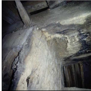
traces de termites sans présence d'individus le jour de la visite sur une poutre dans les combes
