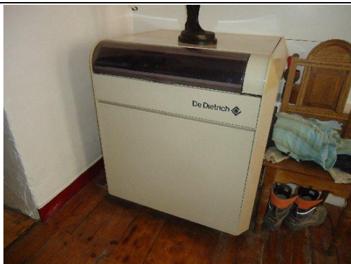
Photo n° DSCN001 Localisation : 1er étage - Salle d'eau 4 Chaudière De Dietrich (Type : Raccordé)
