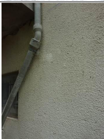
Photo n° 1038A3 Localisation : Extérieur bâtiment Ouvrage : CANALISATION FIBROCIMENT AMIANTE M001
