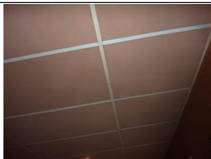
Photo n° 1038A1 Localisation : Séjour Ouvrage : DALLE DE FAUX PLAFOND SUR OSSATURE METAL M003
