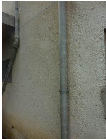
Photo n° 1038A2 Localisation : Extérieur bâtiment Ouvrage : CANALISATION FIBROCIMENT AMIANTE M001
