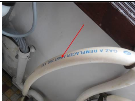
Photo n° Gaz003 14 : la date limite d'utilisation du tuyau d'alimentation n'est pas lisible ou est dépassée. (Rez de chaussée - Buanderie) La date limite d'utilisation du tuyau non rigide est dépassée; Faire intervenir un installateur gaz qualifié afin de remplacer le tuyau existant par un tuyau neuf
