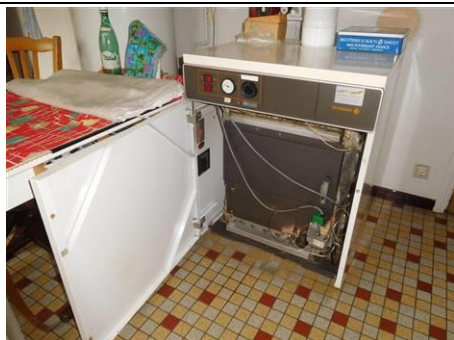
Photo n° Gaz001 Localisation : Rez de chaussée - Buanderie Chaudière DE DIETRICH (Type : Raccordé)
