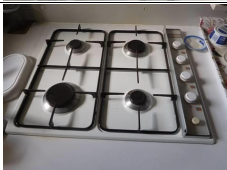
Photo n° Gaz004 Localisation : 1er étage - Cuisine Table de cuisson BRANDT (Type : Non raccordé)
