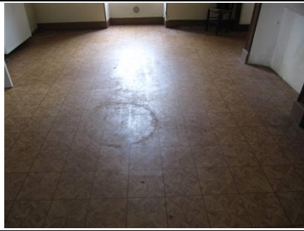
Photo n° A001 Localisation : RDC - Pièce 1 Ouvrage : Planchers Partie d'ouvrage : Dalles de sol Description : Dalles de sol Localisation sur croquis : A1
