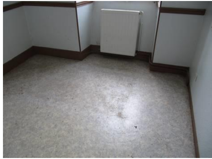
Photo n° A002 Localisation : RDC - Pièce 2 Ouvrage : Planchers Partie d'ouvrage : Dalles de sol Description : Dalles de sol Localisation sur croquis : A2
