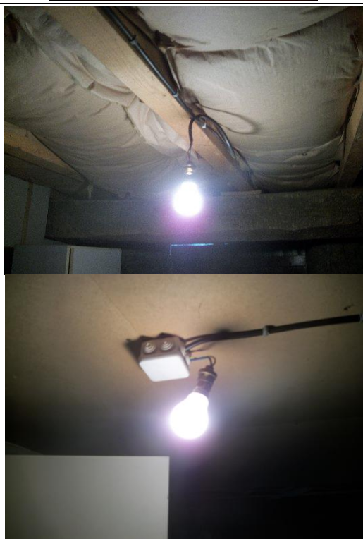
Photo 3 Localisation : 0 - Cellier point lumineux partie sous tension accessible conducteur non protégé mécaniquement
