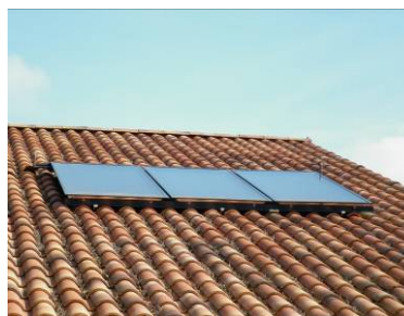
Panneaux solaires thermiques
