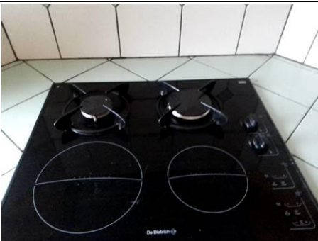
Photo n° PhGaz001 Localisation : Cuisine Table de cuisson DE DIETRICH (Type : Non raccordé)
