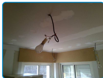
Anomalie B.8.3 b sur Install. n°1
