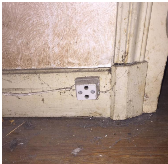
B.8.3 a) : L'installation comporte au moins un matériel électrique vétuste.
