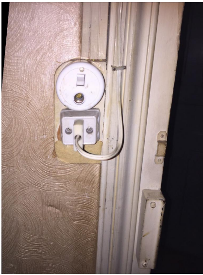
B.3.3.6 a1) : Au moins un socle de prise de courant ne comporte pas de broche de terre.
