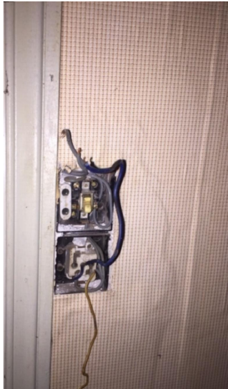
B.8.3 e) : Au moins un conducteur isolé n'est pas placé sur toute sa longueur dans un conduit, une goulotte, une plinthe ou une huisserie, en matière isolante ou métallique, jusqu'à sa pénétration dans le matériel électrique qu'il alimente.
