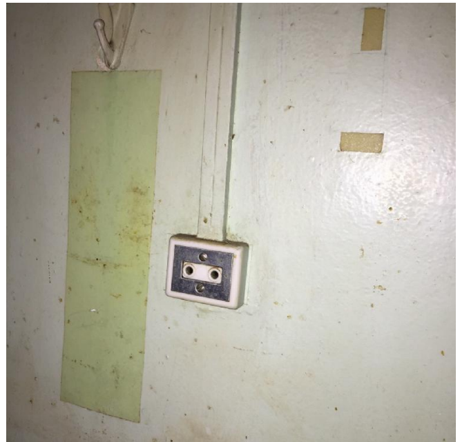
B.3.3.6 a1) : Au moins un socle de prise de courant ne comporte pas de broche de terre.
