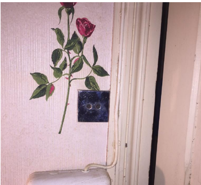
B.8.3 a) : L'installation comporte au moins un matériel électrique vétuste.
