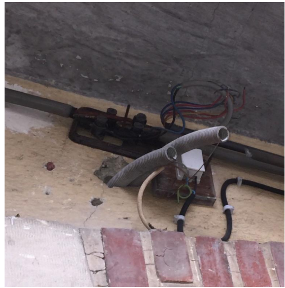
B.8.3 e) : Au moins un conducteur isolé n'est pas placé sur toute sa longueur dans un conduit, une goulotte, une plinthe ou une huisserie, en matière isolante ou métallique, jusqu'à sa pénétration dans le matériel électrique qu'il alimente.
