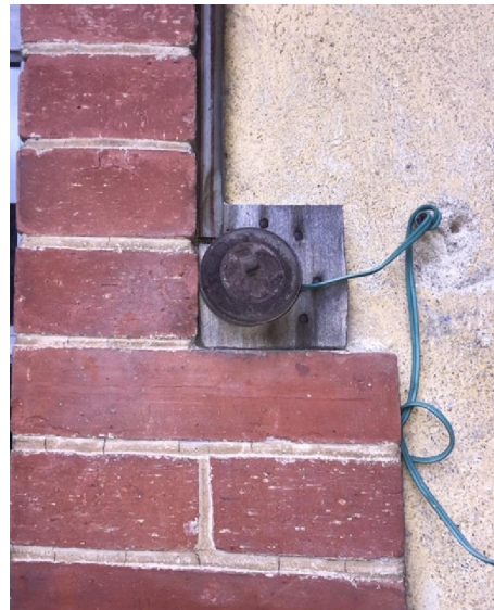
B.8.3 a) : L'installation comporte au moins un matériel électrique vétuste.
