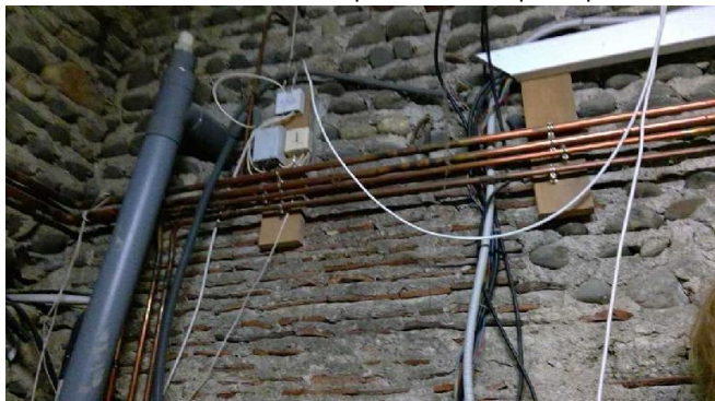
B.8.3 e) : Au moins un conducteur isolé n'est pas placé sur toute sa longueur dans un conduit, une goulotte, une plinthe ou une huisserie, en matière isolante ou métallique, jusqu'à sa pénétration dans le matériel électrique qu'il alimente.
