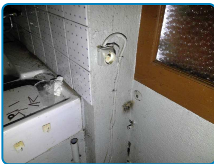
Anomalie B.8.3 e sur Install. n°1
