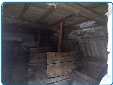
Anomalie B.8.3 e sur Install. n°1
