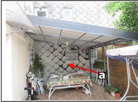
Photo n° PhA001 Localisation : Parties extérieures mur voisin Ouvrage : Bardages Partie d'ouvrage : Plaques fibres-ciment Description : Plaques fibres-ciment Localisation sur croquis : ZPSO-001
