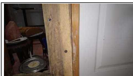
Photo n° Signe de traitement Localisation : Rez de chaussée - Séjour
