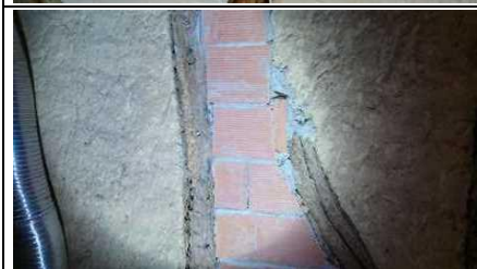
Photo n° Ter002 Localisation : 1er étage - Combles Ouvrage : Colombages Parasite : Présence d'indices d'infestation de termites, Termites souterrains Indices : altérations dans le bois (dégradation(s) faible(s))
