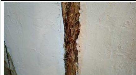
Photo n° Ter001 Localisation : 1er étage - palier Ouvrage : Colombages Parasite : Présence d'indices d'infestation de termites, Termites souterrains Indices : altérations dans le bois (dégradation(s) faible(s))
