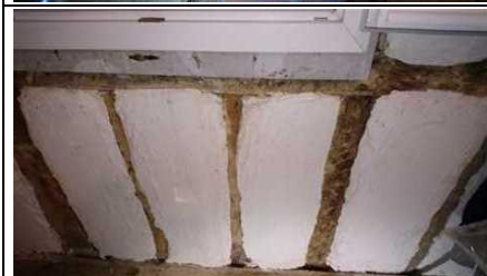
Photo n° Ter003 Localisation : 1er étage - Chambre 5 Ouvrage : Colombages Parasite : Présence d'indices d'infestation de termites, Termites souterrains Indices : altérations dans le bois (dégradation(s) importante(s))
