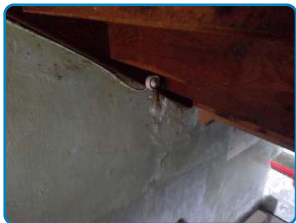
Anomalie B.8.3 a sur Install. n°1
