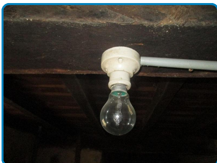
Anomalie B.8.3 a sur Install. n°1
