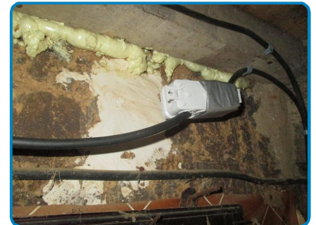
Anomalie B.7.3 a sur Install. n°1
