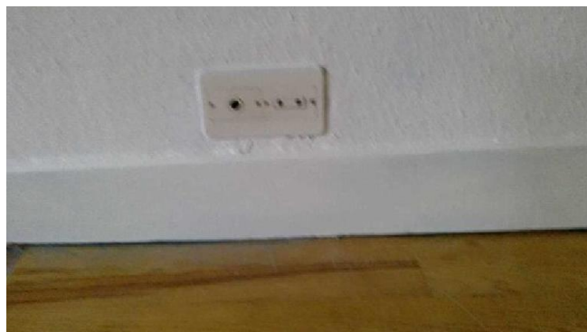
B.3.3.6 a1 ) : Au moins un socle de prise de courant ne comporte pas de broche de terre.
