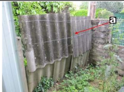
Photo n° A002 Localisation : Parties extérieures Ouvrage : Plaques ondulées Partie d'ouvrage : Plaques en fibres-ciment Description : Plaques en fibres-ciment Localisation sur croquis : 002
