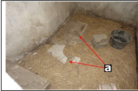
Photo n° PhA002 Localisation : Porcherie Ouvrage : Bardages Partie d'ouvrage : Plaques fibres-ciment Description : Plaques fibres-ciment Localisation sur croquis : 002
