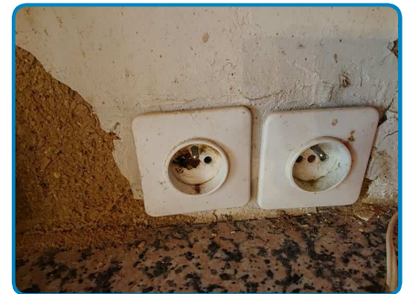
Anomalie B.4.3 h sur Install. n°1
