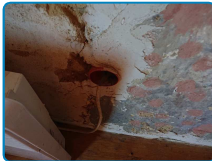
Anomalie B.7.3 a sur Install. n°1
