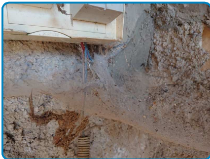
Anomalie B.8.3 e sur Install. n°1
