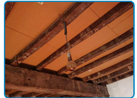
Anomalie B.8.3 b sur Install. n°1
