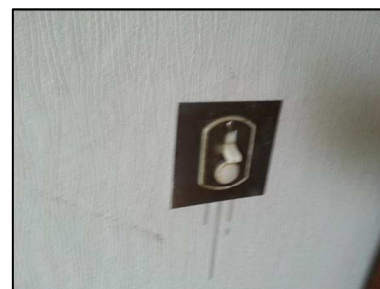
interrupteur porte fusible et matériel vétuste
