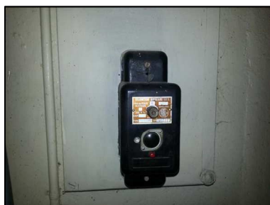
disjoncteur hors service
