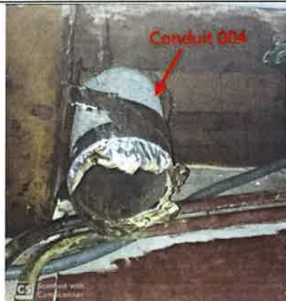
Photo n° PhA004 Localisation : Rez de chaussée - Cuisine Ouvrage : Conduits de fluides (air, eau, autres fluides) Partie d'ouvrage : Conduits Description : Conduits Localisation sur croquis : 004
