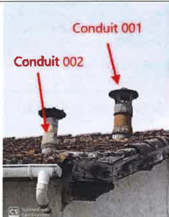
Photo n° PhA002 Localisation : Toiture Ouvrage : Conduits en toiture et façade Partie d'ouvrage : Conduits de fumée en amiante-ciment Description : Conduits de fumée en amiante-ciment Localisation sur croquis : 002
