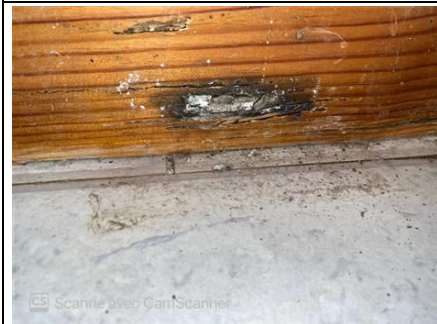
Localisation : 1er étage - Chambre 1 Ouvrage : Plinthes Parasite : Présence d'indices d'infestation de termites Indices : altérations dans le bois (dégradation(s) importante(s))
