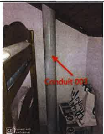
Photo n° PhA003 Localisation : 1er étage - Chambre 1 Ouvrage : Conduits de fluides (air, eau, autres fluides) Partie d'ouvrage : Conduits Description : Conduits Localisation sur croquis : 003
