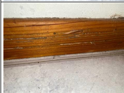
Photo n° PhTer003 Localisation : 1er étage - Chambre 1 Ouvrage : Plinthes Parasite : Présence d'indices d'infestation de termites Indices : altérations dans le bois (dégradation(s) importante(s))
