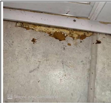
Photo n° PhTer002 Localisation : 1er étage - Chambre 1 Ouvrage : Sol - Parquet et revêtement plastique Parasite : Présence d'indices d'infestation de termites Indices : altérations dans le bois (dégradation(s) importante(s))
