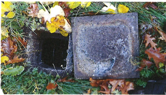
Regard de répartition du traitement Tampon corrodé par les gaz de fermentation
