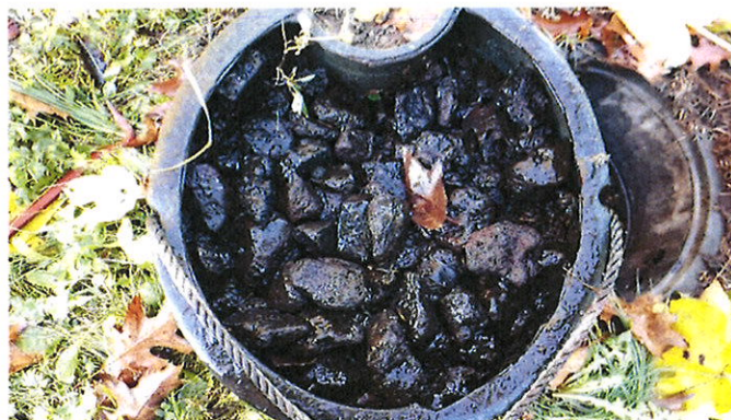
Pré-filtre saturé de la fosse toutes eaux
