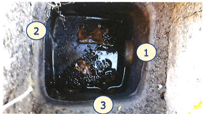
Regard de répartition 1 – Arrivée des eaux usées pré-traitées 2 – Drain supérieur (non alimenté) 3 – Drain inférieur (préférentiellement alimenté)
