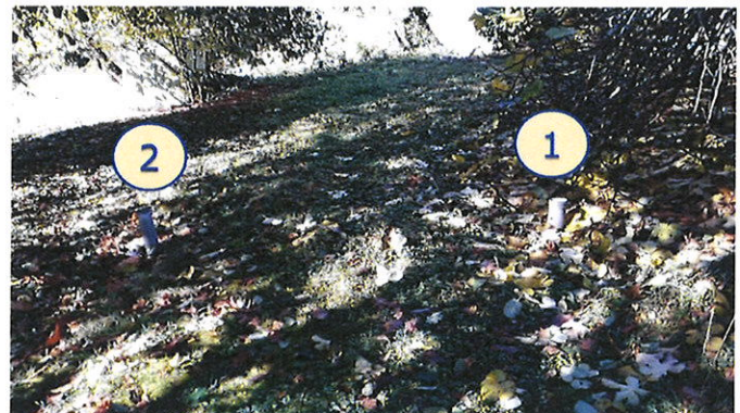
Vue sur la zone de traitement 1 – Té de bouclage du drain supérieur 2 – Té de bouclage du drain inférieur
