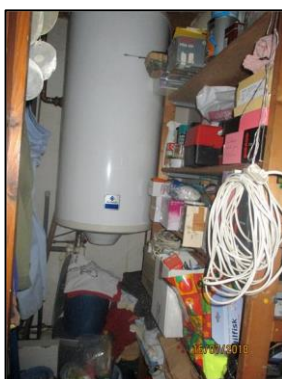
Investigation limitée par endroit en raison de la densité des encombrants (ex : cagibi)
