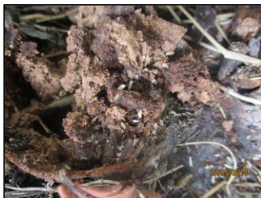
Jardin et dépendance : Indice d'infestation de termites avec activité d'insectes, un traitement de l'ensemble des bâtiments par une entreprise spécialisée est conseillé.
