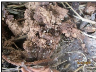
Jardin et dépendance : Indice d'infestation de termites avec activité d'insectes, un traitement de l'ensemble des bâtiments par une entreprise spécialisée est conseillée.
