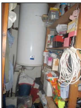
Investigation limitée par endroit en raison de la densité des encombrants (ex : cagibi)
