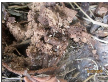
Jardin et dépendance : Indice d'infestation de termites avec activité d'insectes, un traitement de l'ensemble des bâtiments par une entreprise spécialisée est conseillée.
