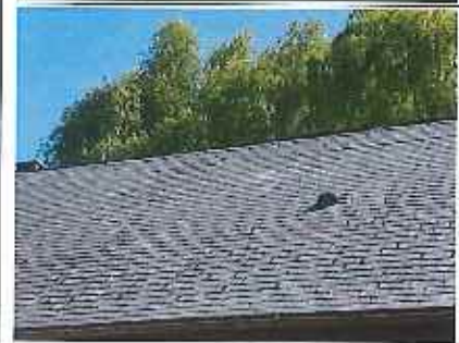
Photo n° PhA002 Localisation : Parties extérieures Ouvrage : 1 - Couvertures, Toitures, Terrasses et étanchéités - Ardoises, bardeaux bitumineux Partie d'ouvrage : Ardoises composites hors fibro ciment Description : Ardoises composites hors fibro ciment
