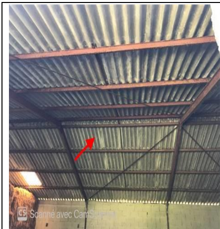
Photo n° PhA001 Localisation : Rez de chaussée - Hangar Ouvrage : Toitures Partie d'ouvrage : Plaques (fibres-ciment) Description : Plaques (fibres-ciment) Localisation sur croquis : ZPSO-001
