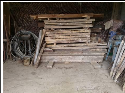
Photo n° 7 Localisation : Annexe - Hangar agricole 1 Ouvrage : Bois stocké au sol Description : La quantité de bois stocké sur le sol ne permet pas une investigation normale de ces éléments.
