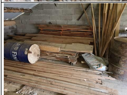
Photo n° 3 Localisation : Annexe - Etage Etable Ouvrage : Bois stocké au sol Description : La quantité de bois stocké sur le sol ne permet pas une investigation normale de ces éléments.
