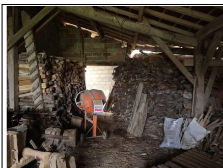
Photo n° 1 Localisation : Annexe - Garage 2 Ouvrage : Sol et bas des murs Description : Le sol et le bas des murs ne sont pas visibles et accessibles en raison du bois stocké au sol. De plus, la quantité de bois stocké sur le sol ne permet pas une investigation normale de ces éléments.
