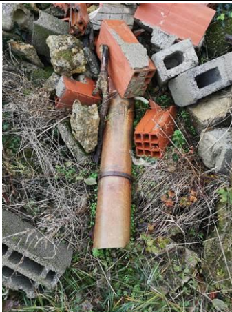
Photo n° 7 Localisation : Parties extérieures derrière le hangar agricole Ouvrage : Conduit de fluide Description : Présence d'un conduit de fluide en fibrociment contenant de l'amiante posé au sol.
