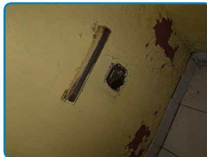
Anomalie B.7.3 d sur Install. n°2
