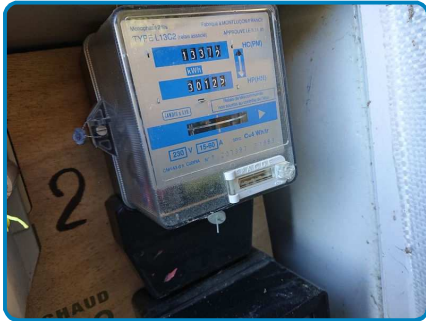
COMPTEUR sur Install. n°2 (dans Château Rez de chaussée Extérieur)
