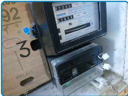
COMPTEUR sur Install. n°3 (dans Château Rez de chaussée Extérieur)
