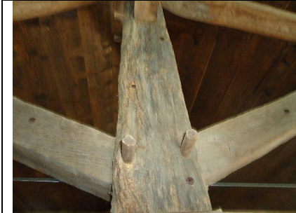
Photo n° DSCN004 Localisation : Charpente Ouvrage : L 'ensemble des bois d 'oeuvre. Description : Doublages partiels empêchant le contrôle (faux plafonds)
