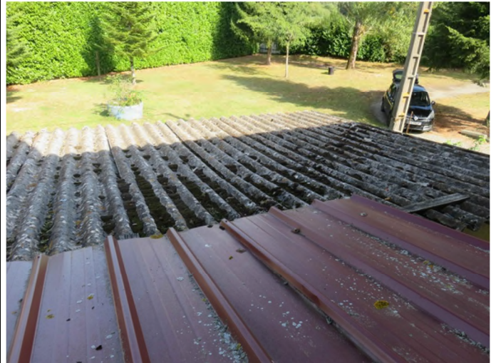
Plaques ondulées en amiante ciment en couverture cuisine été
