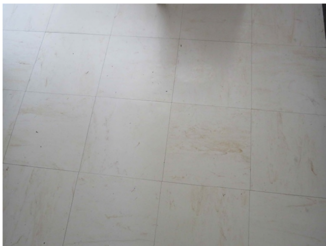
Dalles de sol avec amiante plancher cuisine
