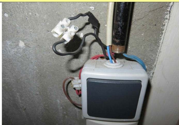
Connexion non protégé garage
