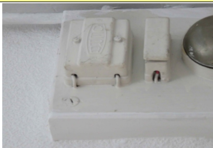
Fusible à broche entrée rdc
