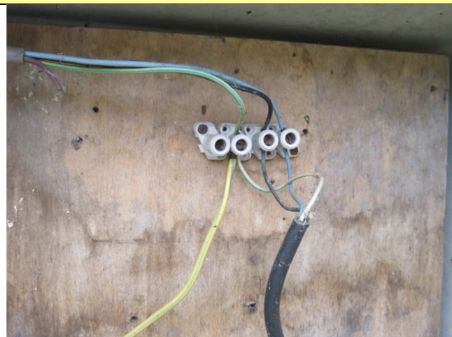
Connexion non protégé garage
