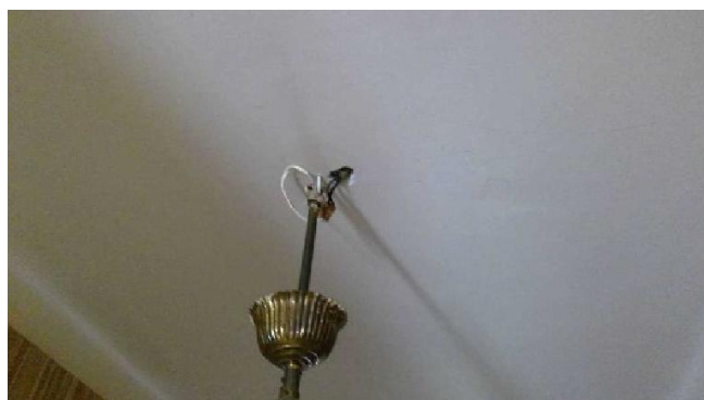
B.8.3 e) : Au moins un conducteur isolé n'est pas placé sur toute sa longueur dans un conduit, une goulotte, une plinthe ou une huisserie, en matière isolante ou métallique, jusqu'à sa pénétration dans le matériel électrique qu'il alimente.
