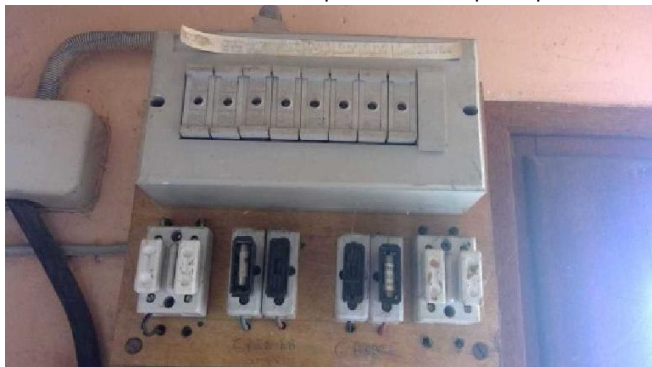
B.8.3 a) : L'installation comporte au moins un matériel électrique vétuste.
