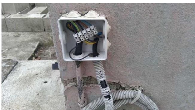
B.8.3 e) : Au moins un conducteur isolé n'est pas placé sur toute sa longueur dans un conduit, une goulotte, une plinthe ou une huisserie, en matière isolante ou métallique, jusqu'à sa pénétration dans le matériel électrique qu'il alimente.
