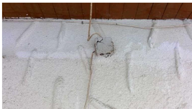
B.7.3 a) : L'enveloppe d'au moins un matériel est manquante ou détériorée.
