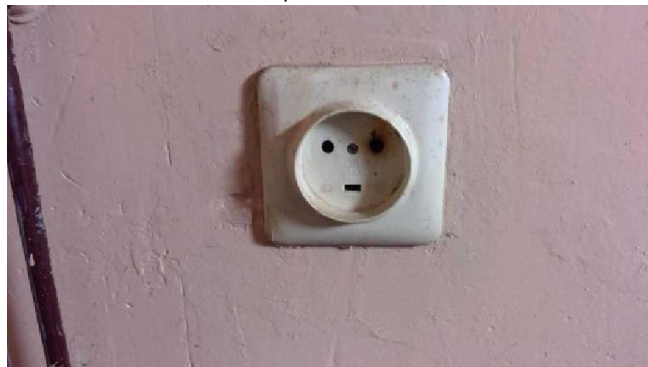
B.8.3 b) : L'installation comporte au moins un matériel électrique inadapté à l'usage.
