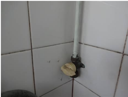
Photo n° PhGaz006 Localisation : Rez de chaussée - Salle d'eau Cuisinière Robinet en attente (Type : Non raccordé)
