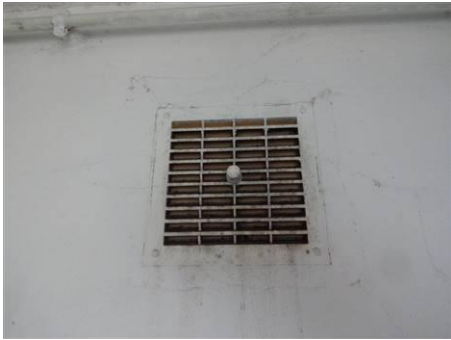
Photo n° PhGaz007 20.4 : Le dispositif de la sortie d'air du local équipé ou prévu pour un appareil d'utilisation est obturable. (Rez de chaussée - Salle d'eau) Présence d'une sortie d'air obturable; Remplacer la sortie d'air obturable par une sortie d'air non obturable
