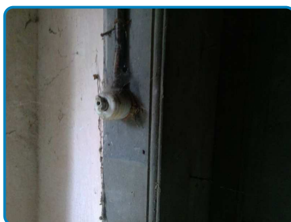
Anomalie B.8.3 a sur Install. n°1
