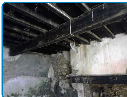
Anomalie B.3.3.6 a3 sur Install. n°2
