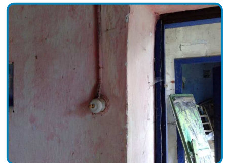
Anomalie B.8.3 a sur Install. n°1
