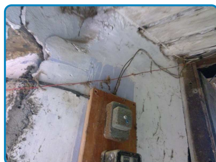
Anomalie B.7.3 d sur Install. n°2 Anomalie B.8.3 e sur Install. n°2
