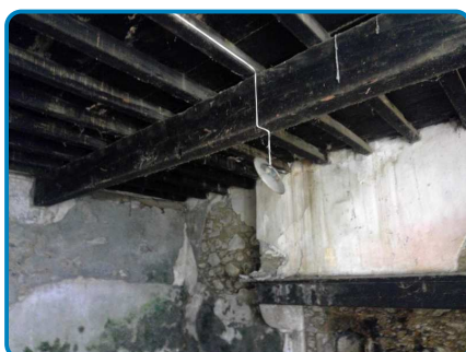
Anomalie B.3.3.6 a3 sur Install. n°2
