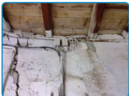
Anomalie B.7.3 a sur Install. n°1 Anomalie B.7.3 e sur Install. n°1
