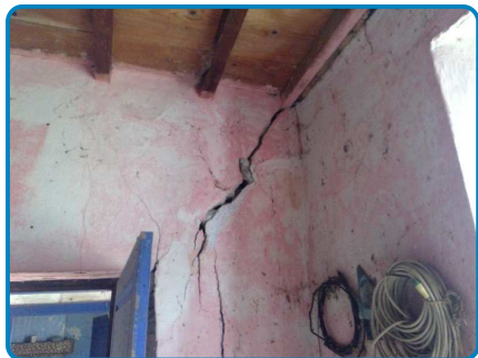
Mur Plâtre Peinture / A (dans Maison principale 1 Rez de chaussée Salle à manger)
