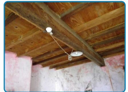
Anomalie B.3.3.6 a3 sur Install. n°1
