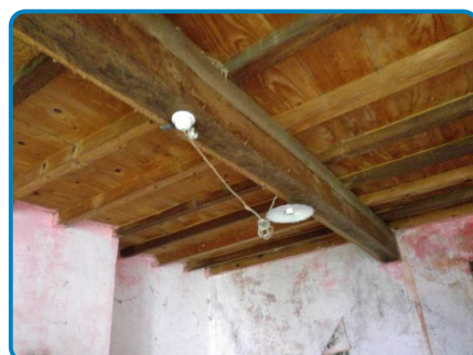
Anomalie B.3.3.6 a3 sur Install. n°1
