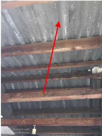
Photo n° PhA001 Localisation : Rez de chaussée - Garage Ouvrage : Toitures Partie d'ouvrage : Plaques (fibres-ciment) Description : Plaques (fibres-ciment) Localisation sur croquis : ZPSO-001
