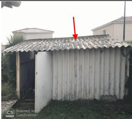
Photo n° PhA003 Localisation : Rez de jardin - Abris de jardin Ouvrage : Toitures Partie d'ouvrage : Plaques (fibres-ciment) Description : Plaques (fibres-ciment) Localisation sur croquis : ZPSO-003
