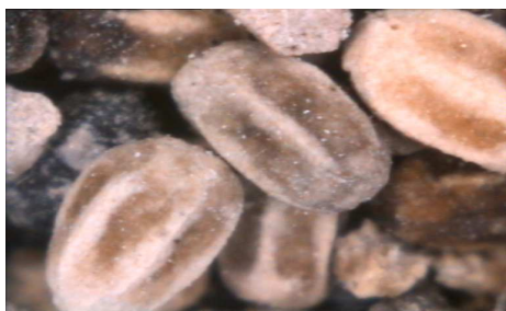
Vermoulures de termites de bois sec
