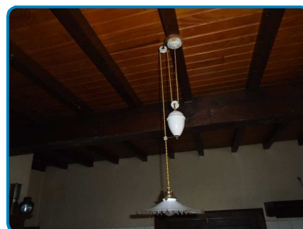
Anomalie B.8.3 a sur Install. n°1
