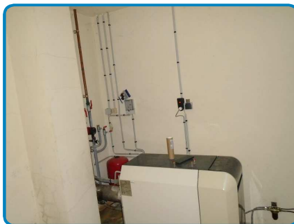
Maison principale Rez de chaussée Chaufferie
