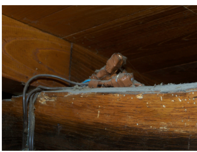
Connexion et isolant inadapté cuisine
