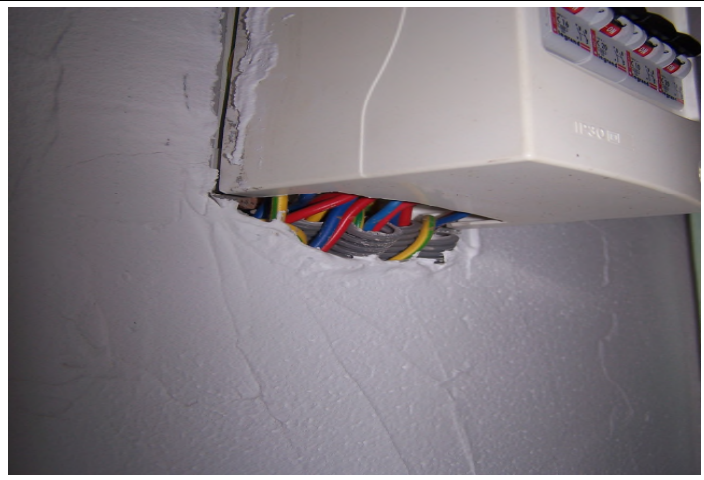
Absence de plinthe boîtier atelier
